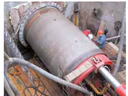
Béton polymère (tuyauteries de battage)
