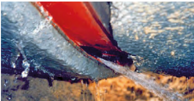
FUITE PAR L'UNION SUR TUYAUTERIE EN BÉTON
